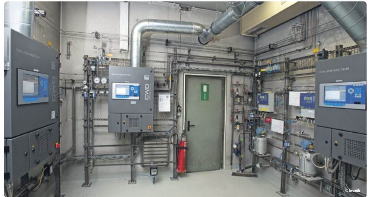
In der Kalorimeter-Messstation am Standort Marl wird der Brennwert der anfallenden Prozessgase mit Hilfe von drei Kalorimetern bestimmt
